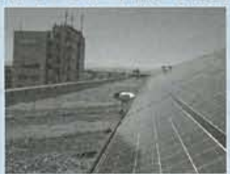
緑化された屋上とソーラーパネル
